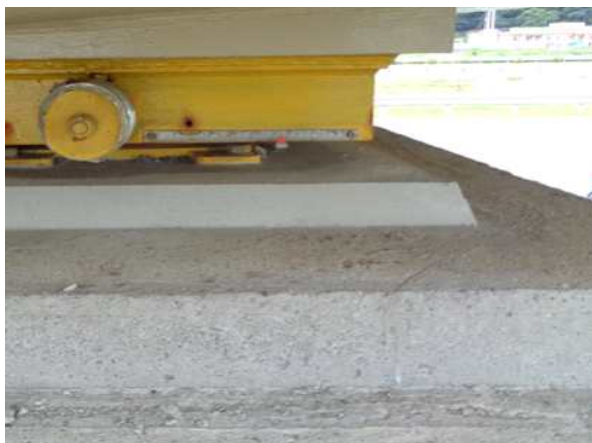
교량받침 A1-Sh2 받침콘크리트 재료분리 ( 0.3 \times 0.3 )
