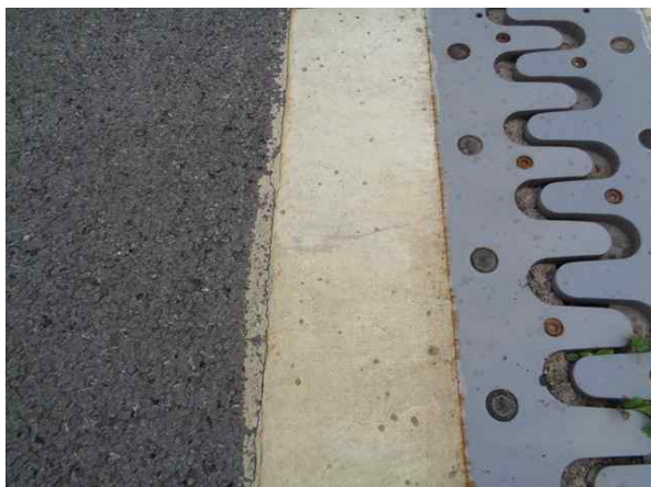
신축이음 A1 후타재 균열( Cw=0.3\text{mm} 미만)
